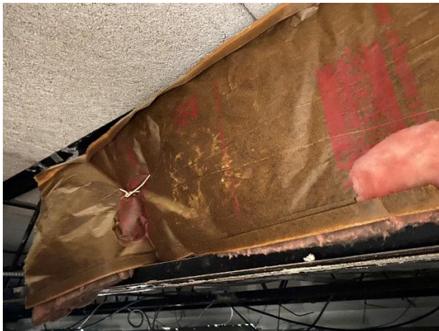
HVAC Duct Wrap
